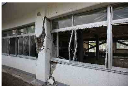
耐震補強されていない被災状況
